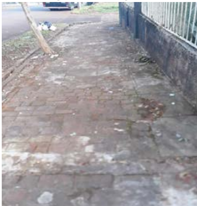
Fotografia 1 - Passeio público danificado que dificulta a acessibilidade.
